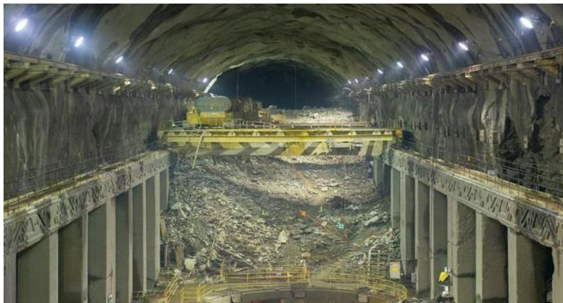
Foto 1. Caverna de Máquinas.
