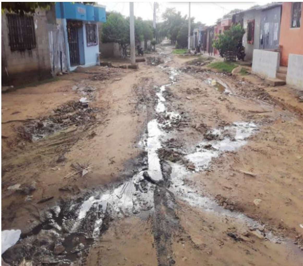
Figura 5. Falta de acceso al alcantarillado
