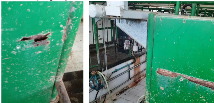
Figura 15: Beltrán, F. (2022). Compartimiento en el área de ordeño oxidado y deteriorado, [Fotografía].
