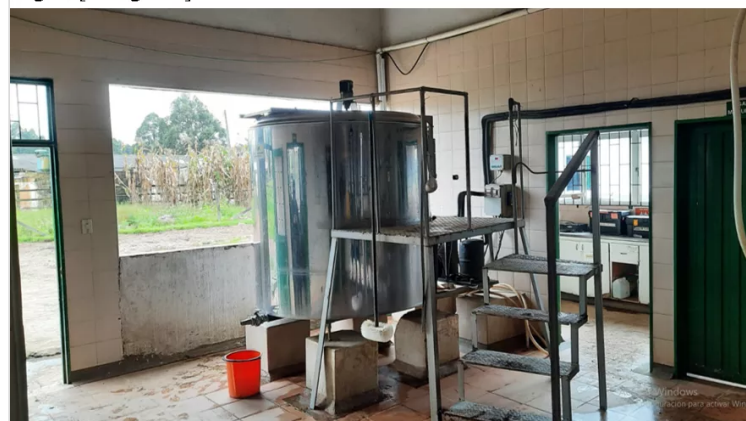
Figura 10: Beltrán, F. (2022). Cuarto del tanque de refrigeración sin ventana ni angeo, [Fotografía].
