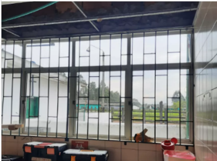
Figura 14: Beltrán, F. (2022). Cuarto de almacenamiento de medicamentos y equipos veterinarios sin cielorraso, [Fotografía].
