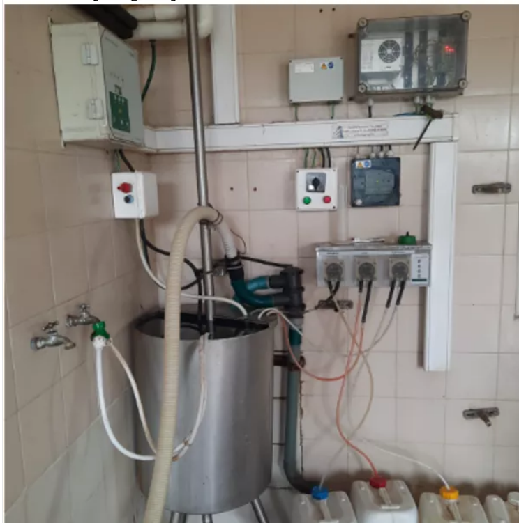
Figura 12: Beltrán, F. (2022). Equipo de Agua caliente que se encuentra inhabilitado [Fotografía].
