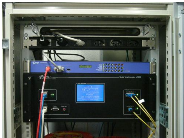
Fig 8 se observa un Cerberis que fue utilizado en el sistema de distribución de claves cuánticas en las elecciones nacionales suizas, el cual se diseñó para proteger la línea exclusiva que transmite las papeletas a la estación de recuento.
