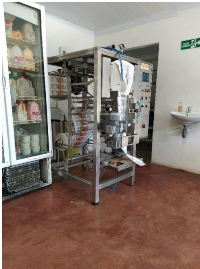
Foto 1. Maquina selladora, refrigeración producto terminado
