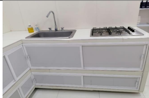
Área de meson de calentamiento y lavado
