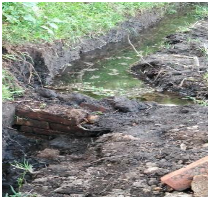
Escorrentías de Aguas Grises Expuestas
