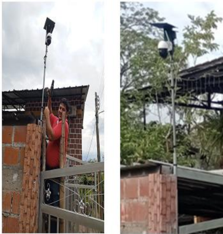
Fotografía Instalación Cámara IP
