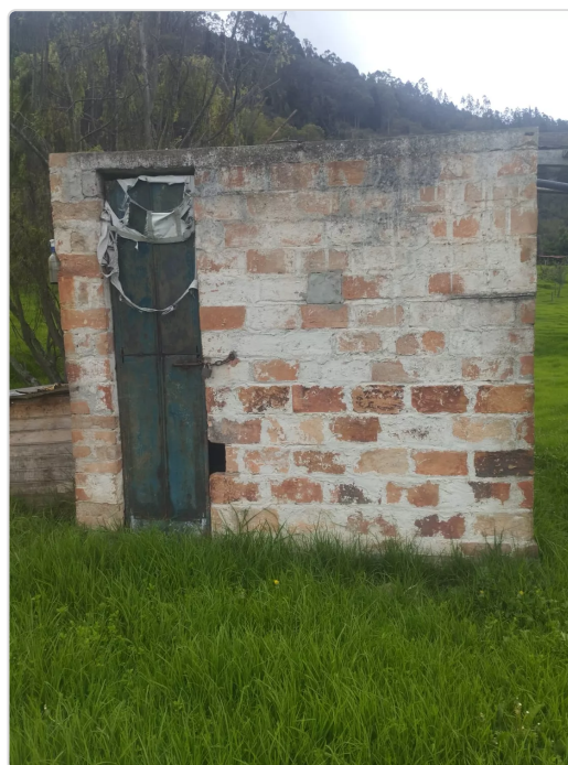
Figura 7. Cuarto de máquinas
