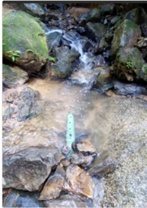
Figura 6. captación del agua del nacimiento propio denominado “Agua Bonita”.
