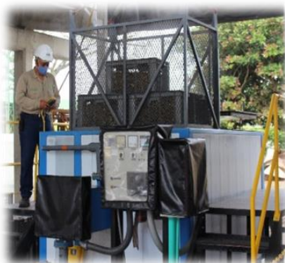
Imagen tratamiento térmico
