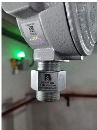
Baliza luminosa para indicación de gas peligroso
