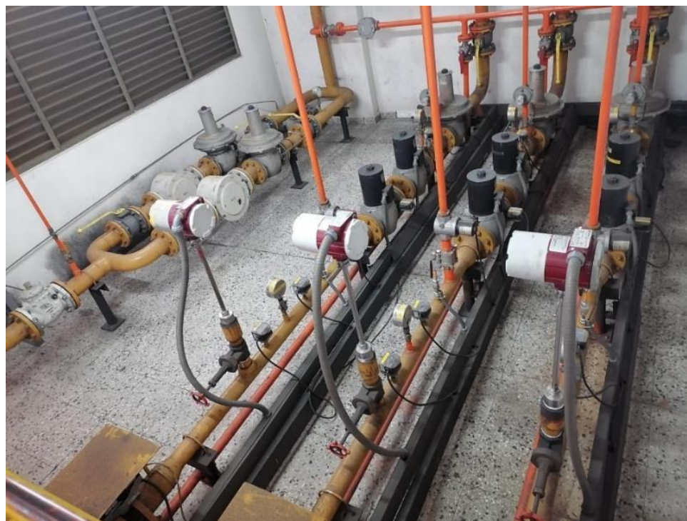
Estación reguladora de gas natural
