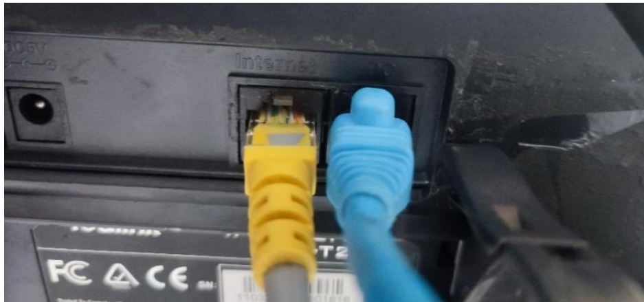
Conexiones teléfono Yealink
