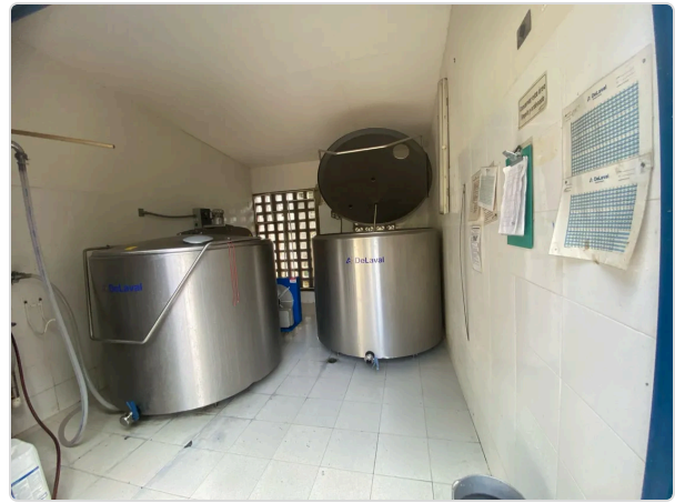
Figura 6. Tanques de almacenamiento de leche.
