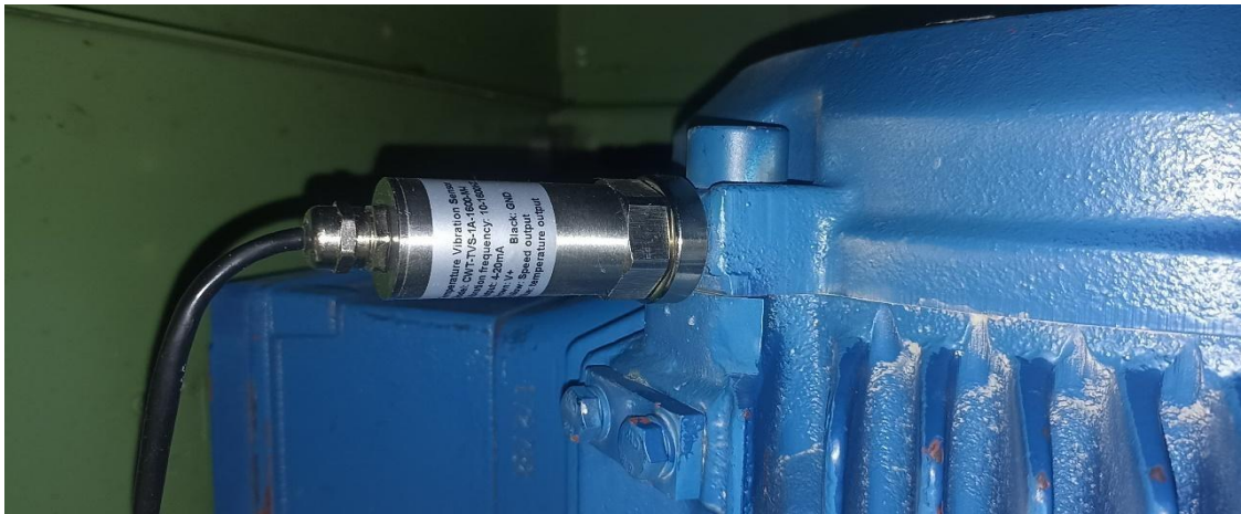
Sensor de Vibración y Temperatura en el Motor
