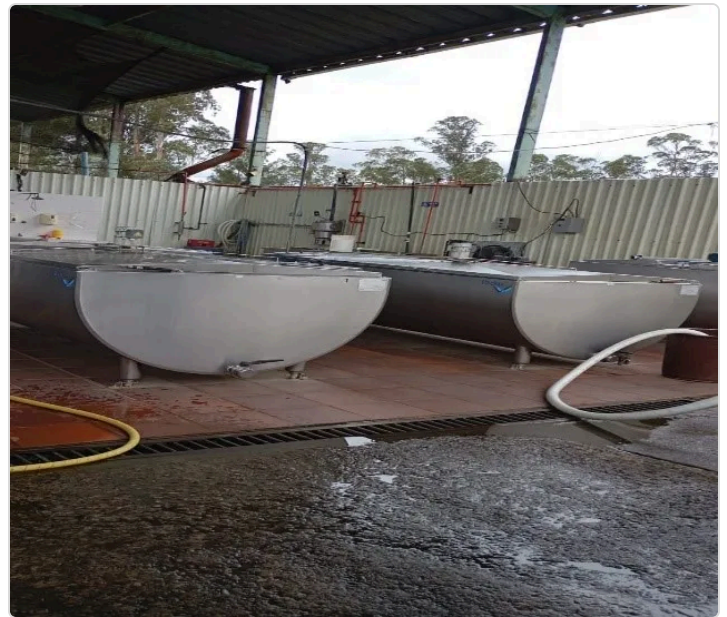
Figura 2. Tanques de enfriamiento
