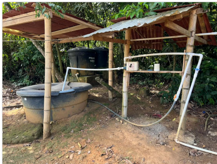
Figura 5. Acopio y tratamiento de agua para las aves.
