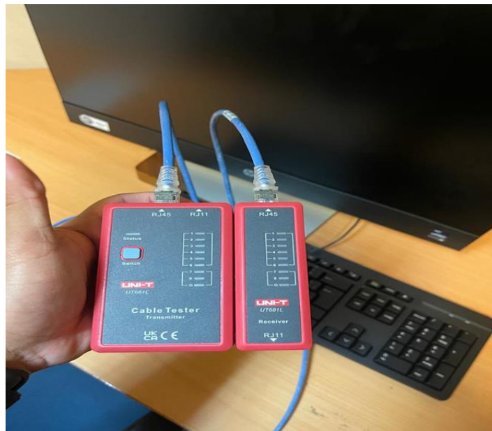
Figura 5: Verificación de la continuidad de los cables RJ45 de conexión de red local.
