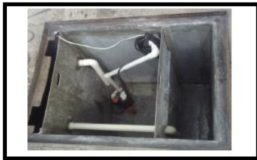
Imagen 10. Rejilla, trampa de grasas y bomba sumergible Fuente de autor Hernández. D, (2016)
