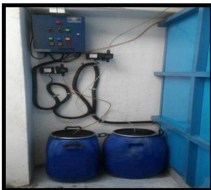
Imagen 16. Tanques De Reactivos y Bombas Dosificadoras Fuente de Autor Hernández. D, (2016)
