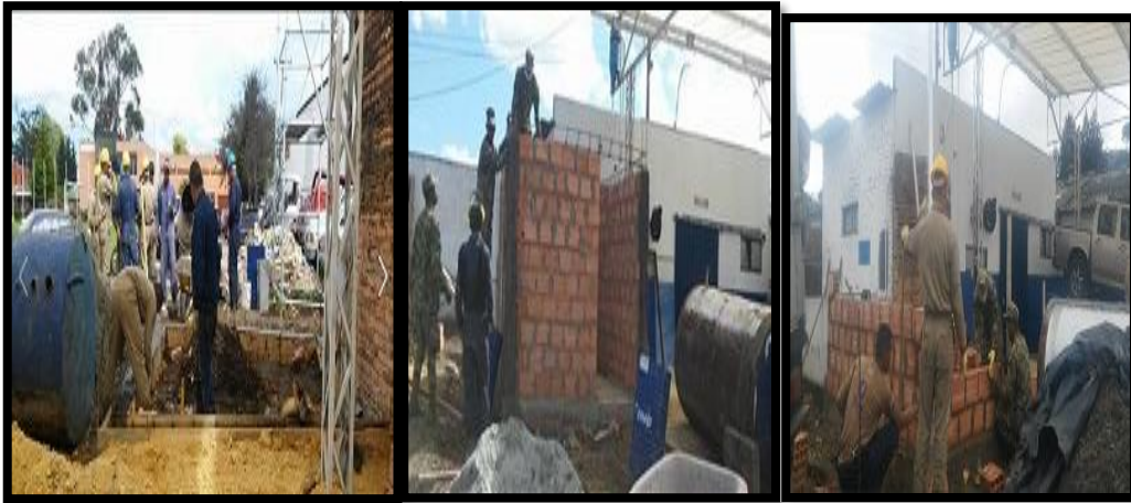
Imagen 5. Inicio de Obra Vigas de Amarre, Levantamiento de Paredes y Techado de Nueva Infraestructura. Fuente de Autor Hernández. D. (2016)
