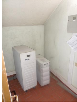
Figura 13. Sistema de Alimentación Ininterrumpida
