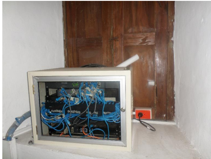
Figura 16. Armario de telecomunicaciones
