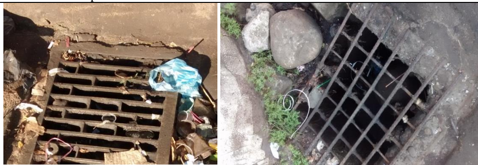
Cajas iniciales sistema de alcantarillado con residuos de aceite usado sector la playa Barrio el Raicero
