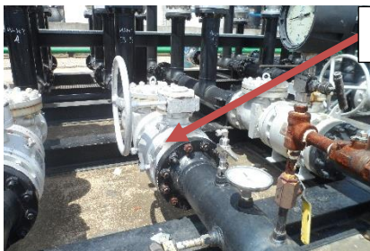
Bloqueo de válvula en entrada en Manifold
