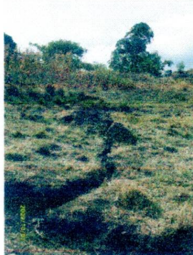
GRIETA ENCONTRADA EN AL PARTE SUPERIOR DE LA VIA EL ESPINO CAPITANEJO
