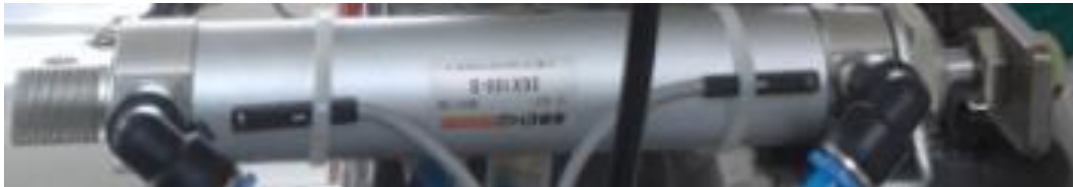
Fotografía 4. Sensores magnéticos en actuador neumático.
