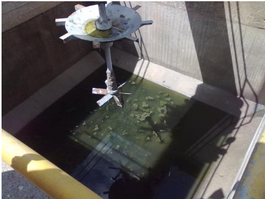
Figura 8. Aireadores en tanque de homogenización
