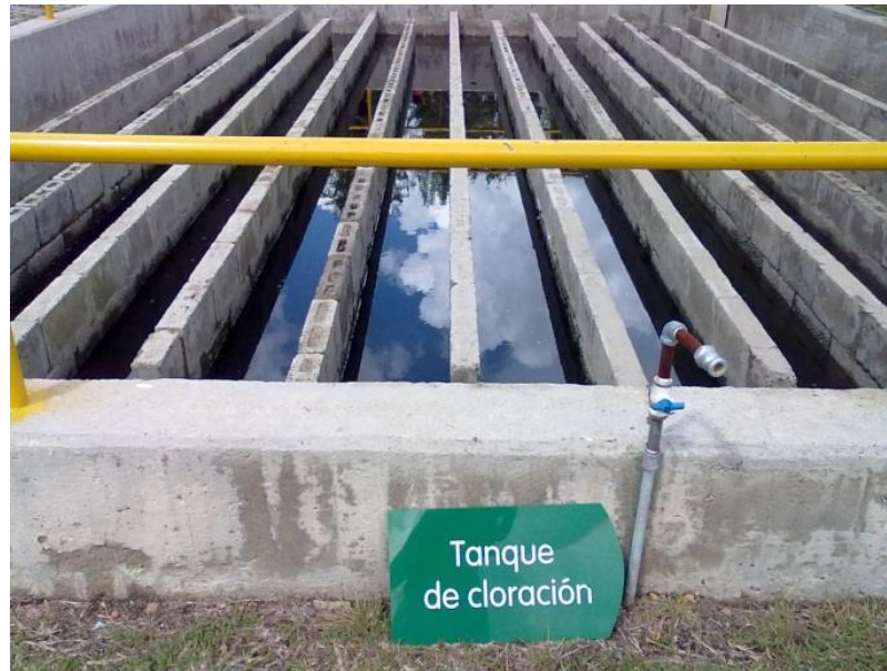
Figura 9. Tanque de Cloración
