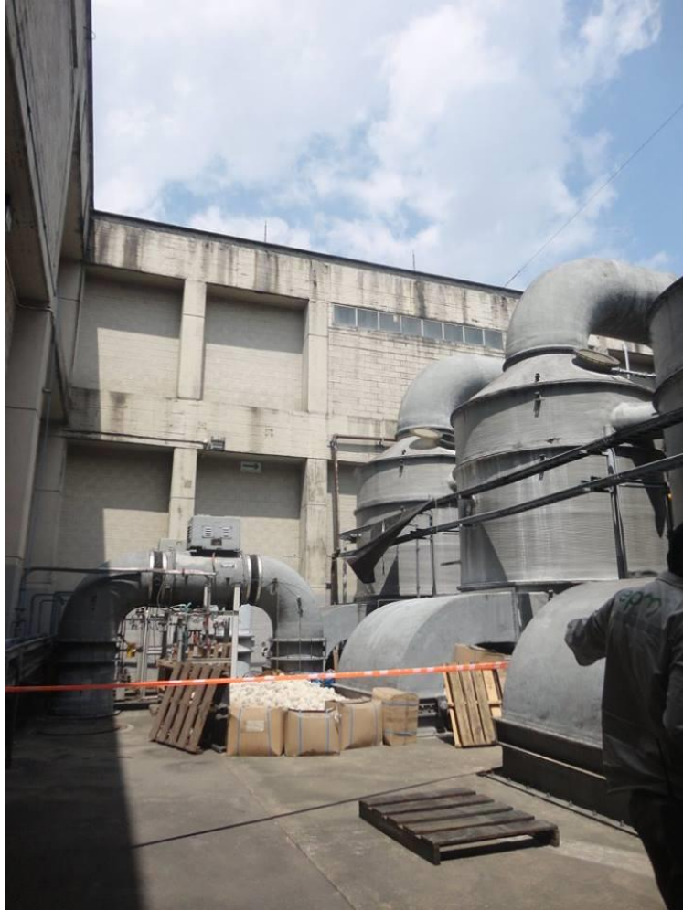
Figura 3. Depurador de lecho empacado PTAR San Fernando
