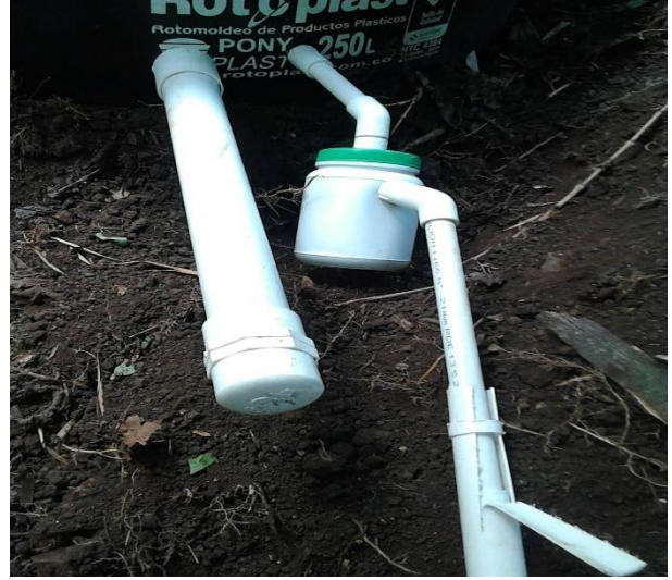
Fig. 29. Filtro de salida de la recámara
