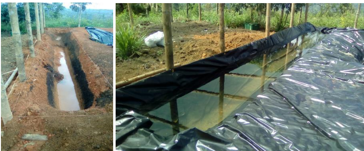
Imagen 56: canal cosecha de agua lluvia
