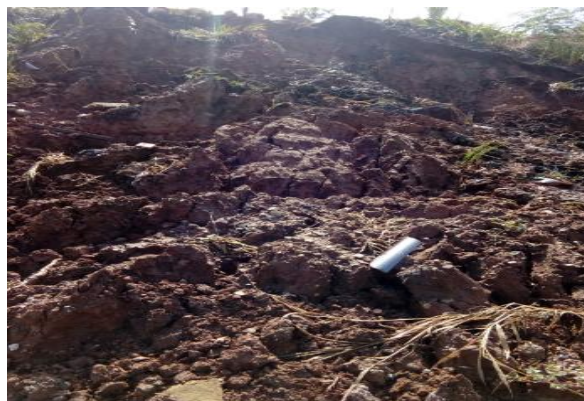
Imagen 5. Deslizamientos sobre talud celda 2
