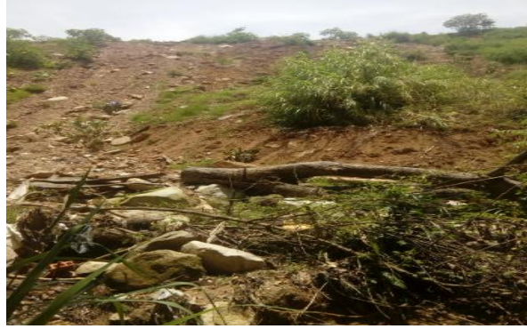
Imagen 6. Desestabilización de taludes celda 1.
