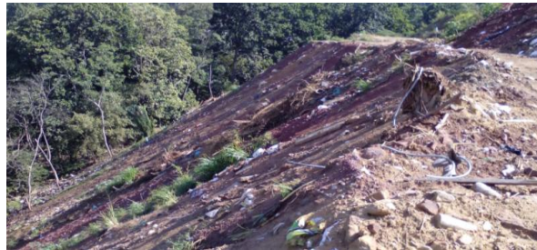
Imagen 4. Estado talud celda 2
