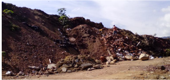
Imagen 3. Estado inicial de talud celda 1
