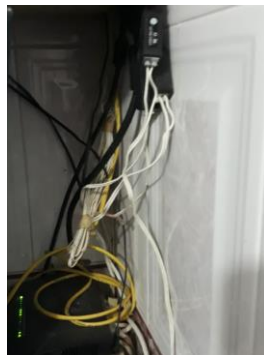
Figura 8. Disposición del Cable de red
