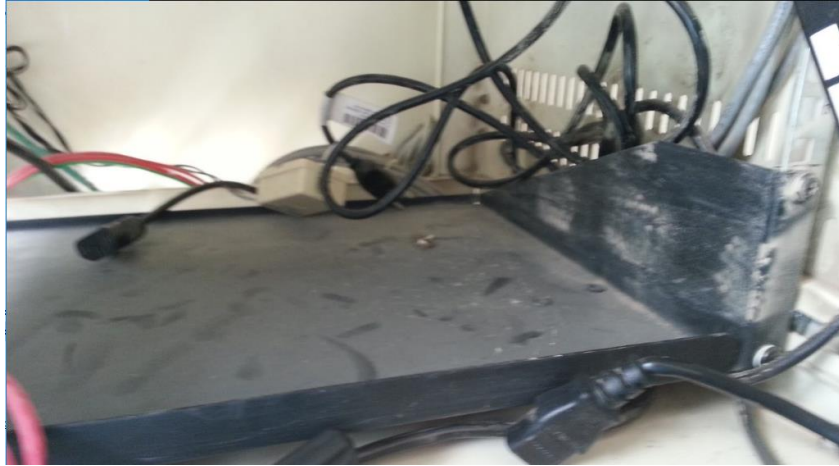
Figura 10. Gabinete en mal estado
