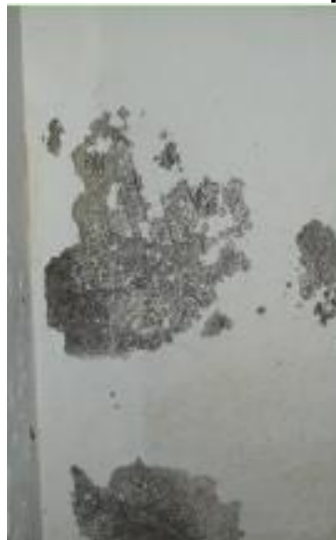
Figura 12. Deterioro de la pared
