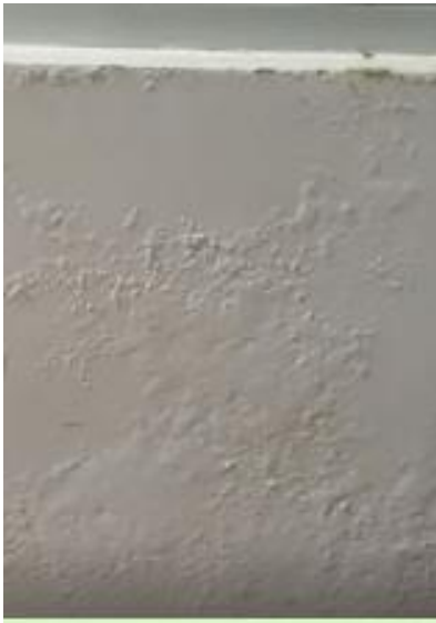
Figura 11. Paredes con humedad
