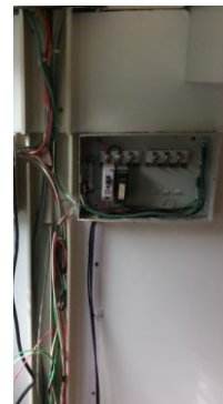
Figura 9. Disposición del Cable Eléctrico
