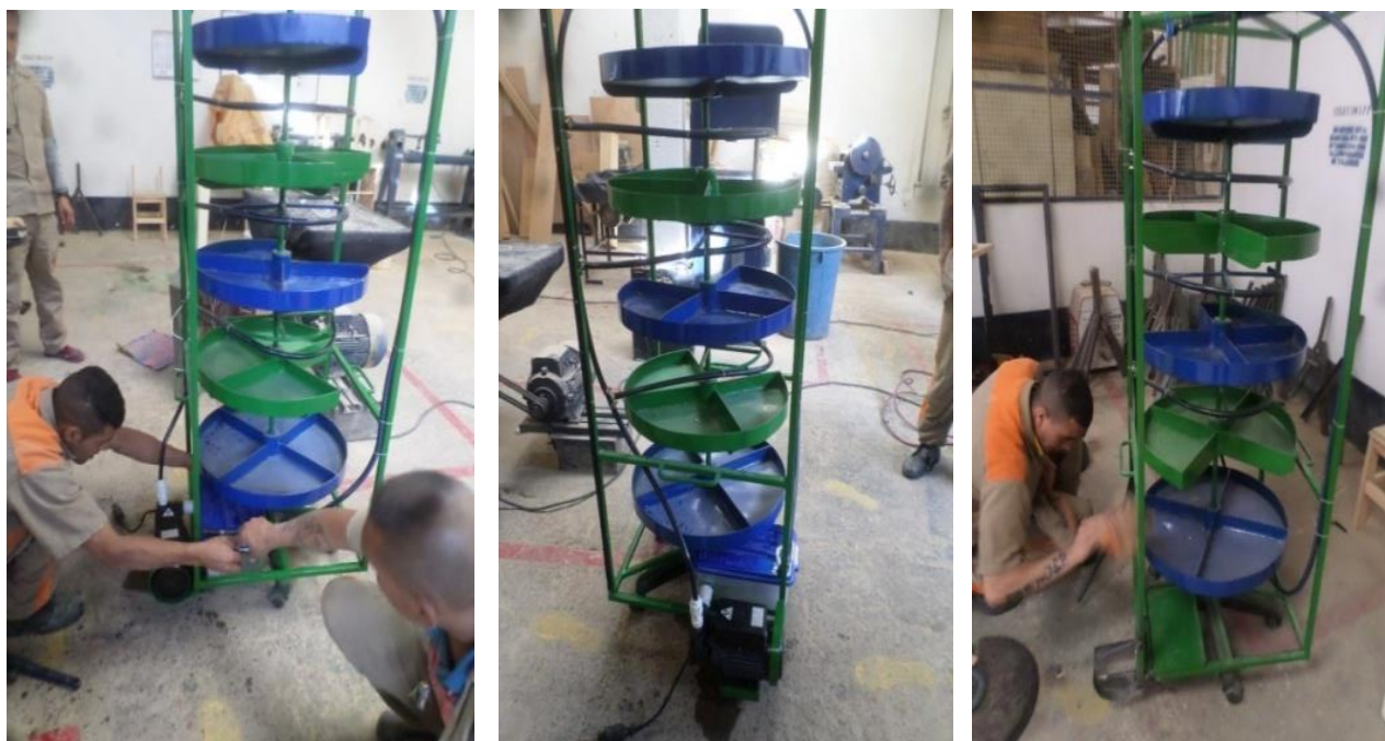
Fotografías 9, 10 y 11: evidenciamos la instalación de recipiente plástico que simula un reservorio o fuente de agua, electrobomba y red para riego por aspersión.
