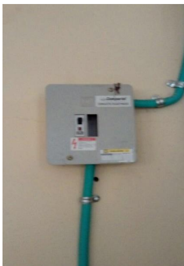
Fig. 11. Caja de instalaciones eléctrica del Colegio
