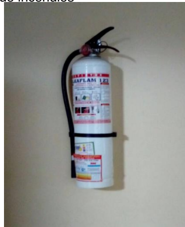
Fig. 10. Control de incendios
