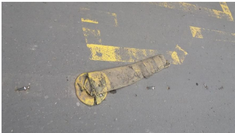
Figura 19 Estas señales en su mayoría se encuentran destruidas.
