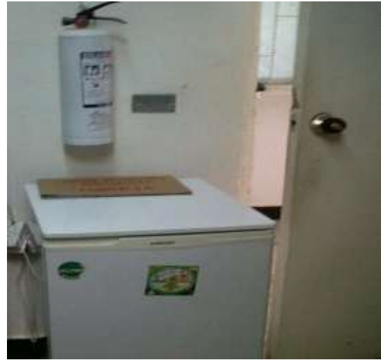
Ilustración 13 Extintor en área no adecuada
