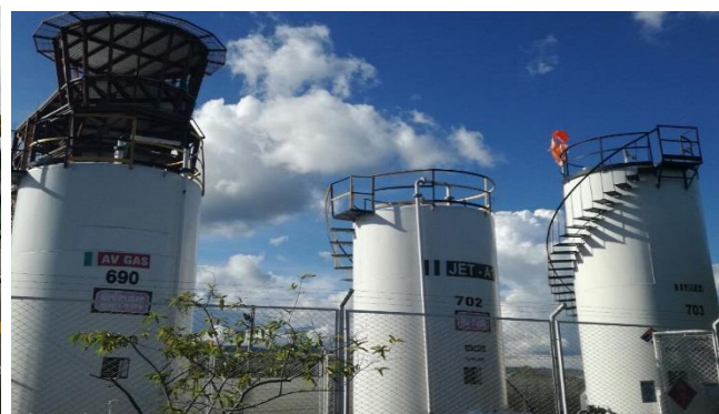
Foto 4. Panorámica tanques almacenamiento de combustible de aviación
