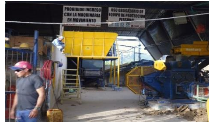
Fotografía 5. Área de maquinaria Fuente. Archivo de las Autoras
