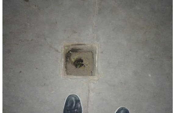
Figura 28. Drenaje sin rejilla
