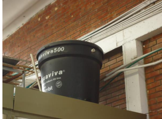
Figura 12. Tanque de almacenamiento de 1000Lts
