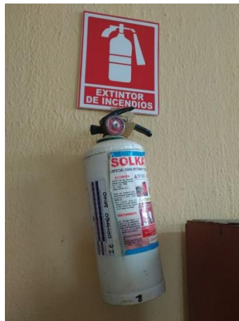
En las anteriores fotografías se evidencia protección contra incendios, tanto para elementos tecnológicos como para elementos comunes.
