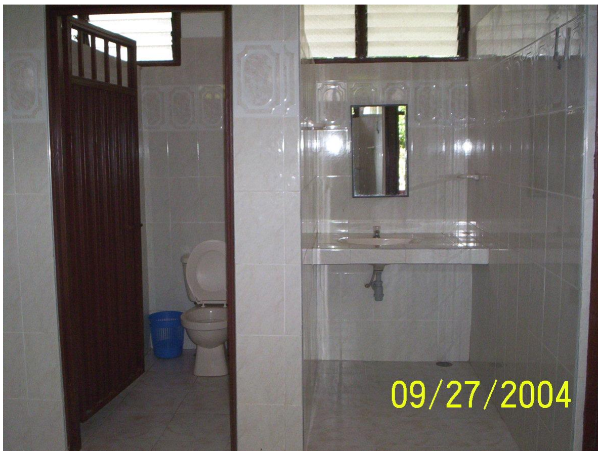
Figura 10. Sanitario y lavamanos
