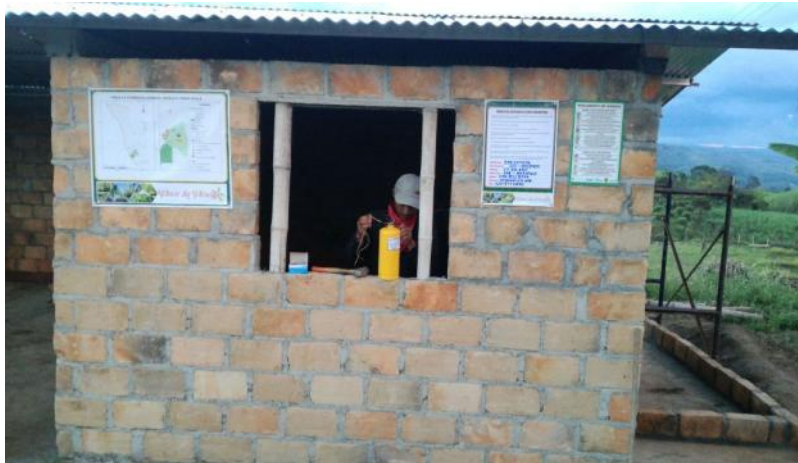
Ilustración 18. Puesta de extintor de seguridad en la bodega de la unidad productiva la Floresta.
