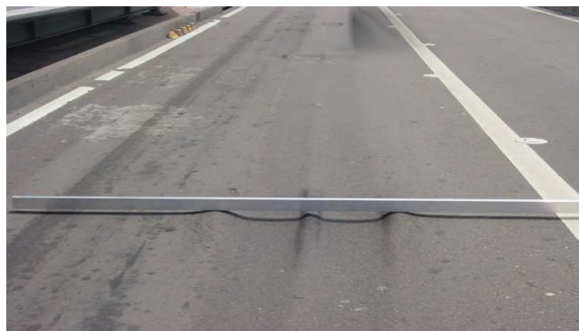
Imagen 9: Fenómeno del ahuellamiento. Vía Calle 80 Bogotá Colombia Fuente: Reyes Ortíz & Camacho Tauta, (2004)
