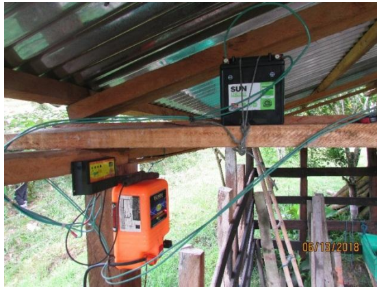
Figura 31 Inversor y batería panel solar finca corazones. Fuente: Ricardo Urbano
