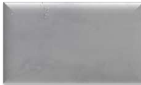
Imagen 21. Defecto por grieta
