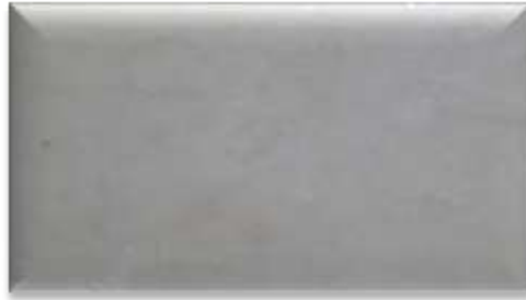
Imagen 29. Defecto por protectora rayada
