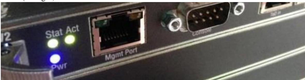
Figura 52. Indicadores de señal testigos. Fuente: autoría propia, 2018
