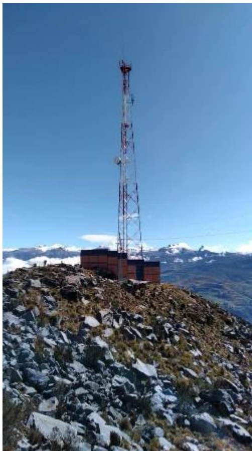
Figura 25. Torre de instalación EB el Cocuy Fuente: autoría propia, 2018
