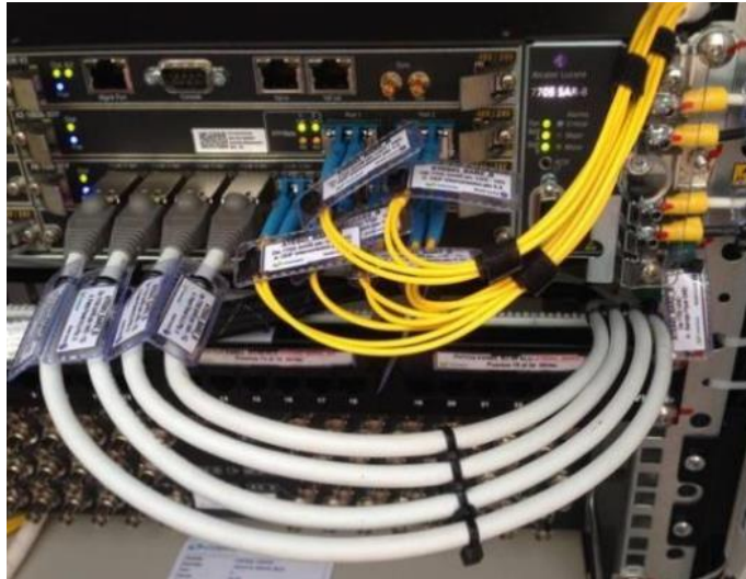
Figura 47. Instalación. Fuente: autoría propia, 2018
