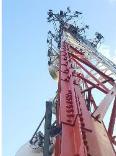
Figura 21. Torre de antenas. Fuente: autoría propia, 2018
