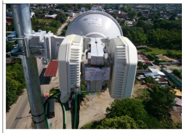
Figura 29. Mástil, herraje, IDU y antena. Fuente: autoría propia, 2018
