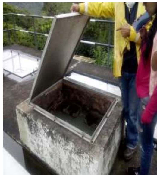
FIGURA 39. TRAMPA DE GRASAS Fuente: Propia
