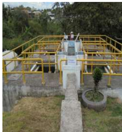
FIGURA 25. TRAMPA DE GRASAS Distribución de caudal Fuente: CAM Territorial Sur
