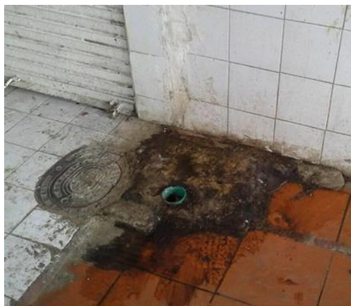
Figura 29. Desagües inadecuados. Fuente: Propia
