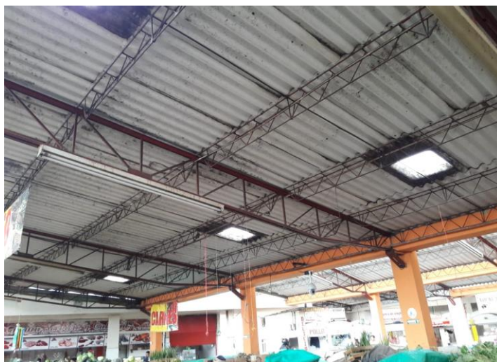
Figura 39. Cubiertas y Estructura Metálica en mal Estado Fuente: Propia
