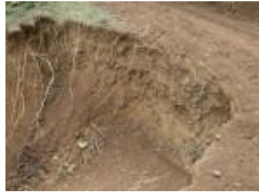
Erosión por pata de vaca
