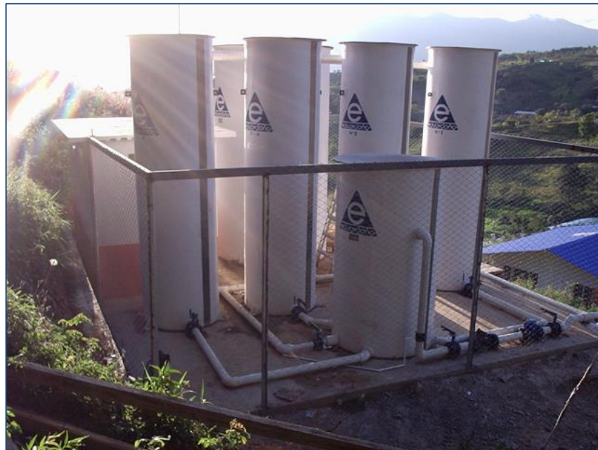
Figura 9. Planta de tratamiento de agua potable abierta modular
