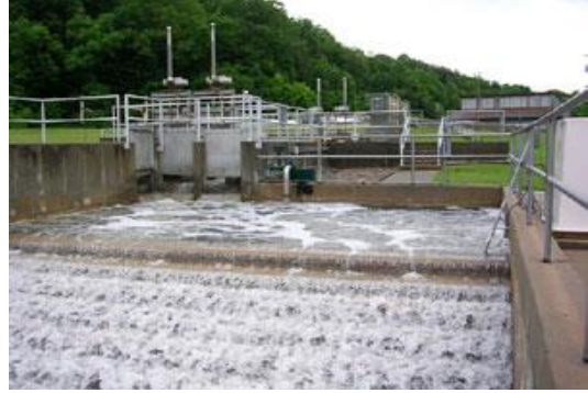
Figura 2. Aireación tipo escalera en planta de tratamiento convencional
