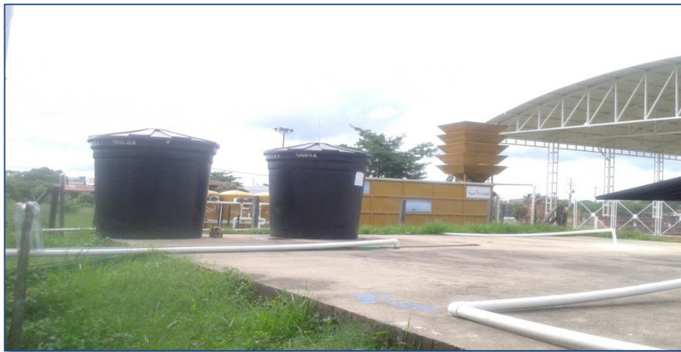
Figura 30. Planta de tratamiento compacta, pozo profundo San Jorge.
