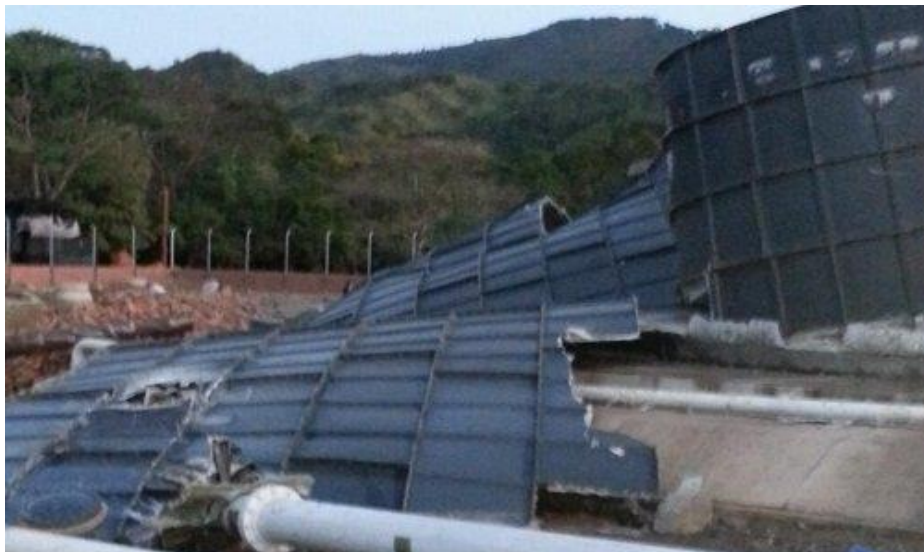
Figura 22. Tanque de la planta modular que colapso en las pruebas previas a la inauguración el día 20 de diciembre del 2013.
