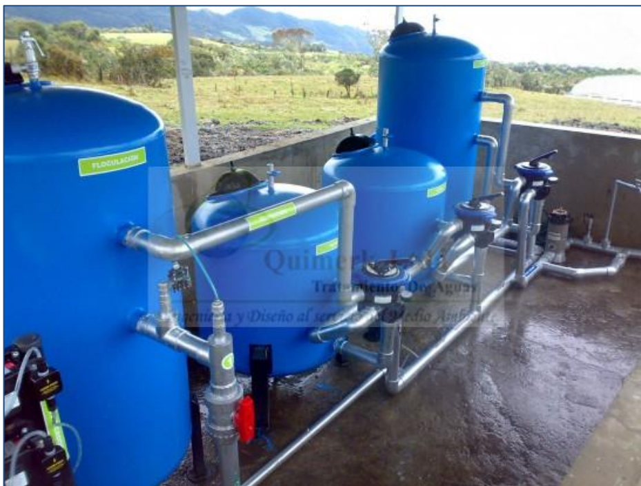
Figura 10. Planta de tratamiento de agua potable compacta
