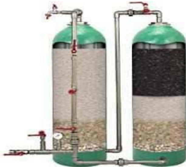
Figura 8. Plantas de tratamiento de agua potable presurizadas
