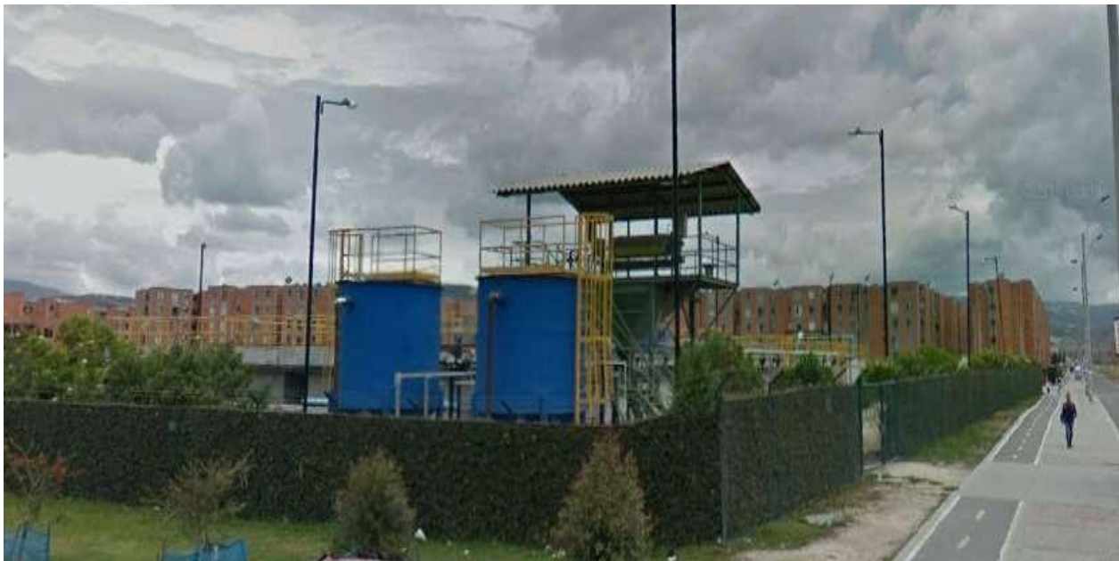
PTAR de Apiros S.A.S Planta de Tratamiento de Aguas Residuales, allí se tratan las aguas residuales domésticas del Proyecto Hogares Soacha, Urbanización El Silo y el Barrio La Veredita, que luego se descargan en el Río Soacha
