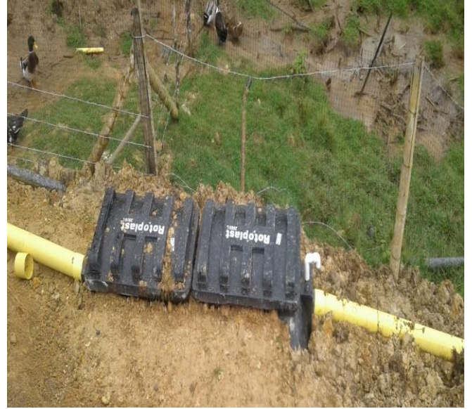
Sistema de tratamiento Vereda el Cedro (Elaboración propia)
