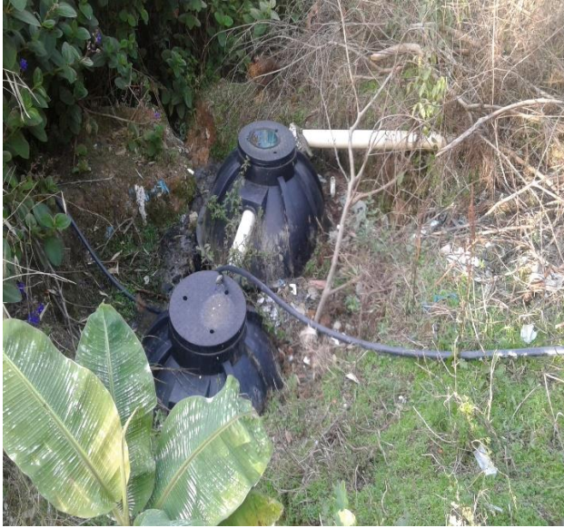
Oxidación y infiltración (Elaboración propia)
