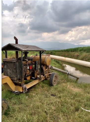
Ilustración 20. Sistema de bombeo diesel.
